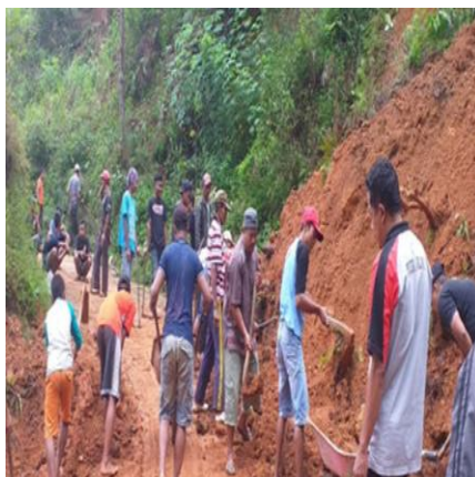
Gambar 4 Kondisi Akses Jalan Selur-Trenggalek Setelah Terjadi Tanah Longsor
